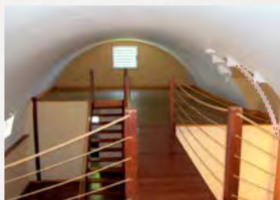
Maison de M me Guéneau – Au-dessus de la porte, une des armatures métalliques apparentes en pointillé (coll. FP 2013).
